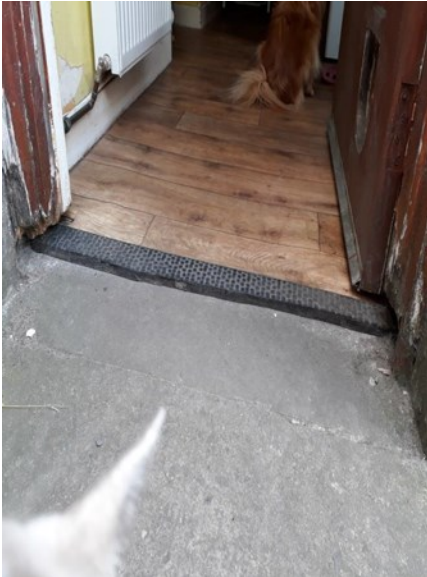
Photo 1: Rotten door frame
